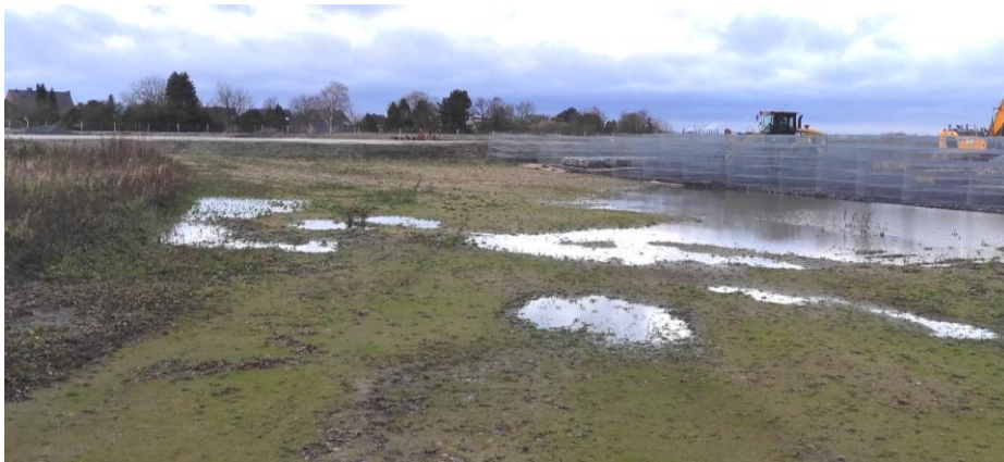
Abbildung 15: Temporärgewässer und Pfützenbildung in unbefestigten Baustelleneinrichtungsflächen nördlich der Straße „Hagelkreuz“ (eigene Aufnahme 07.01.2025)
