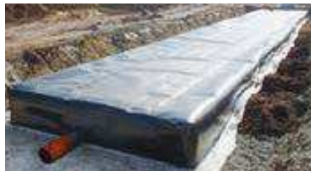
Regenwasserspeicher mit Folienummantelung
